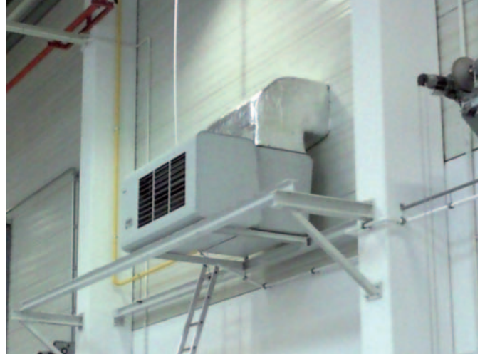
RIPRESA ARIA ESTERNA EXTERNAL AIR INTAKE
